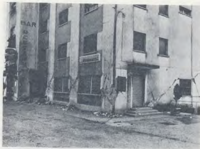
Bild 17. Fünfgeschossiges Hotelgebäude bei Venzone mit Wänden aus behauenen Natur- und Backsteinen. Beschädigung im Erdgeschoss durch typische X-Risse in den Fensterposten der Vorderfront und Diagonalriss auf der Stirnseite infolge inhomogenen Fundationsverhältnissen
