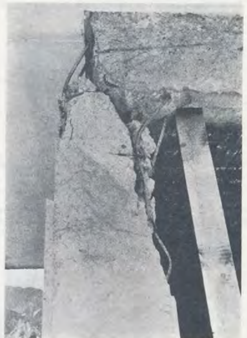
Bild 19. Abscheren einer Stütze bei der Verbindung mit dem Riegel infolge ungenügender Verbügelung
