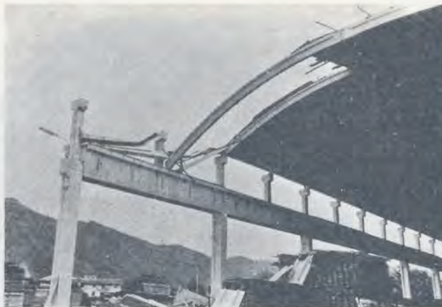
Bild 20. Offene Halle aus vorfabrizierten Stahlbetonelementen südlich Magnano. Dachbinder als Dreigelenkbogen mit Zugband auf Stützen aufgelegt. Einsturz eines Dachsegments und Beschädigung eines weiteren Segments infolge Abgleiten des Binders ab dem Auflager
