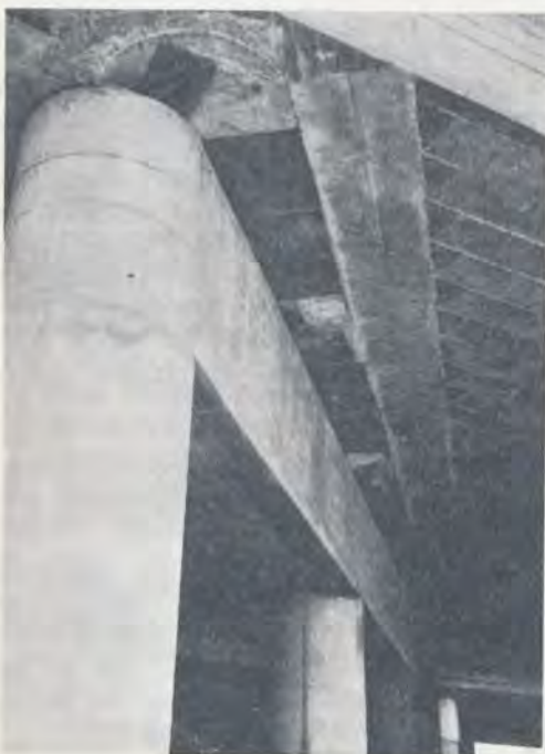
Bild 22. Dreifeldrige Autobahnbrücke über die Strasse Buia-Maiano. Brückenträger infolge starken seitlichen Verschiebungen von den Neoprenelagern auf die Stützenjochs heruntergefallen
