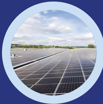
Eine der grössten PV-Anlagen im Kanton Zürich: 13'077 m 2 , 2,5 Mio. kWh Strom pro Jahr
