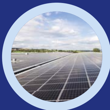
L'une des plus grandes installa- tions photovoltaïques du canton de Zurich: 13 077 m 2 , 2,5 millions de kWh d'électricité par an
